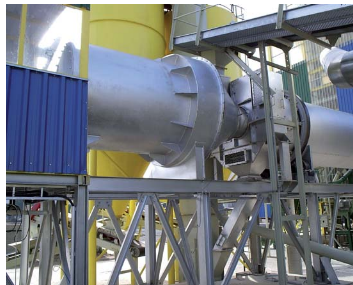
Afb. 2 De verbrandingskamer van een trommeldroger
